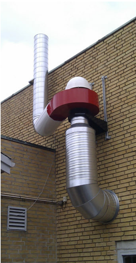
Vejrbestandig ventilator monteret udendørs på væg. Frekvensreguleret.
