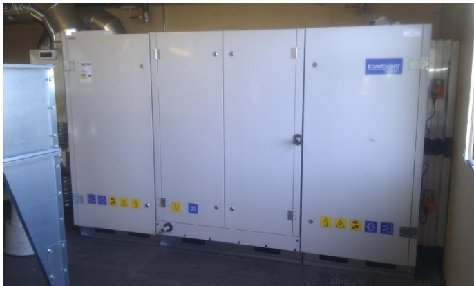
Komplet ventilationsanlæg med integreret styring og touch-panel for styring af anlæggets drift. Monteret med frekvensomformere.
