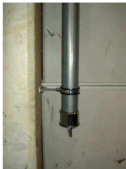
Rørsystem udført i stål, afsluttet med sugedudtag, ligeledes i stål.
