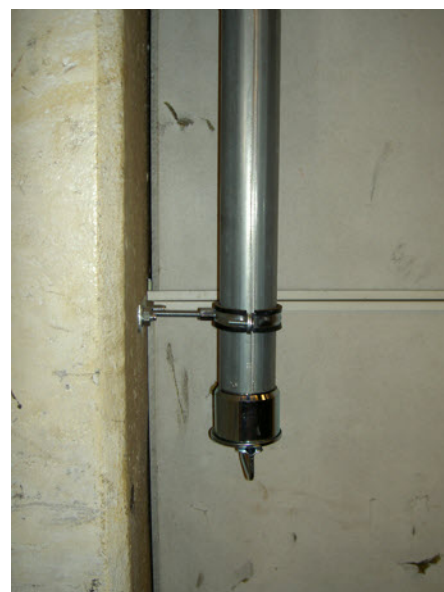
Rørsystem udført i stål, afsluttet med sugeudtag, ligeledes i stål.
