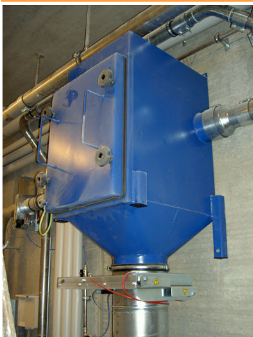
Filteranlæg med bundspjæld for udladning af materiale direkte i snegl der kører til container..
