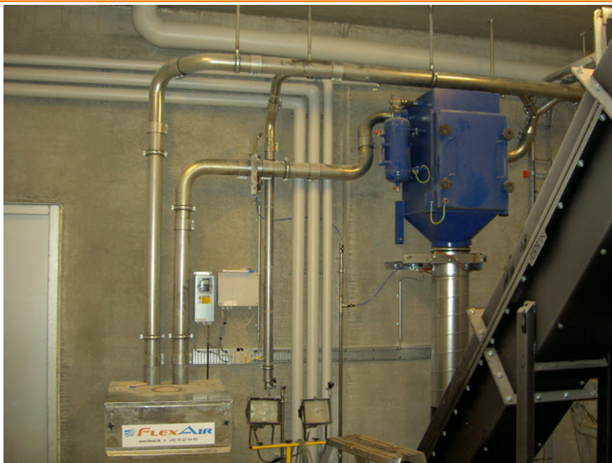
Filteranlæg sammenkoblet med vakuumpumpe i støjdæmpende kabinet. Filteranlæg er med automatisk filterrensning via trykluftimpulser.
