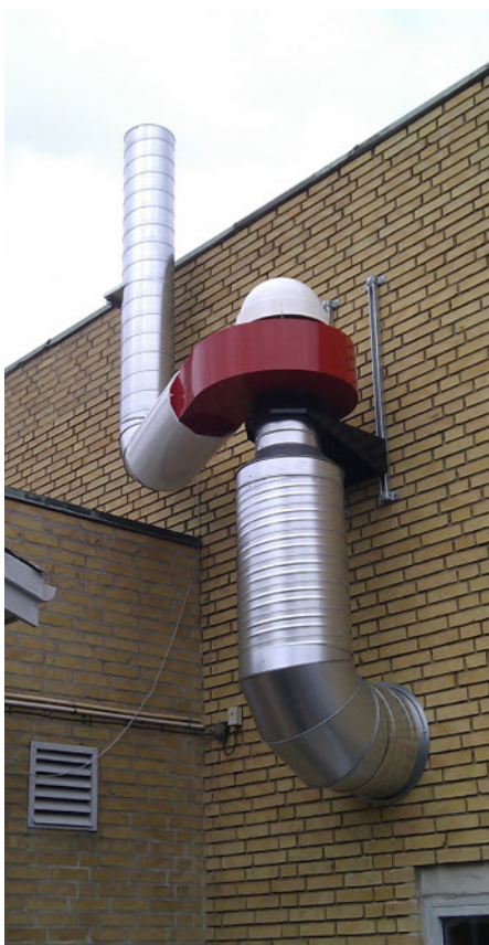
Vejrbestandig ventilator monteret udendørs på væg. Frekvensreguleret.
