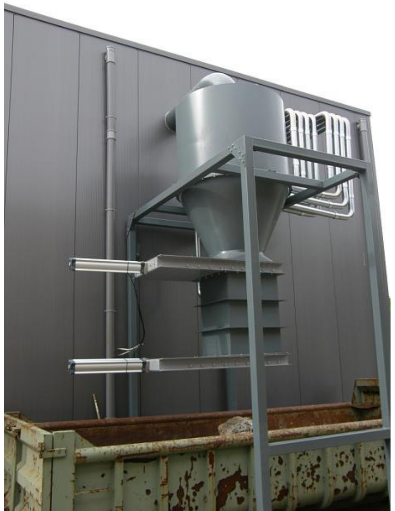
Komplet cyklonudskiller på benstativ med indløb af i alt 8 hovedrør fra produktionen hvor støv og spåner løber ind i cyklonudskilleren.
