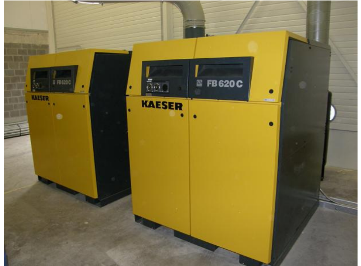
Vakuumpumper med samlet effekt på 90 kW.
