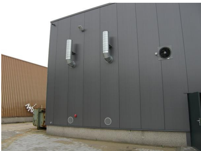
Maskinhus set udefra - luftafkast fra de 2 vakuumpumper samt ventilator for ventilation af maskinhus.
