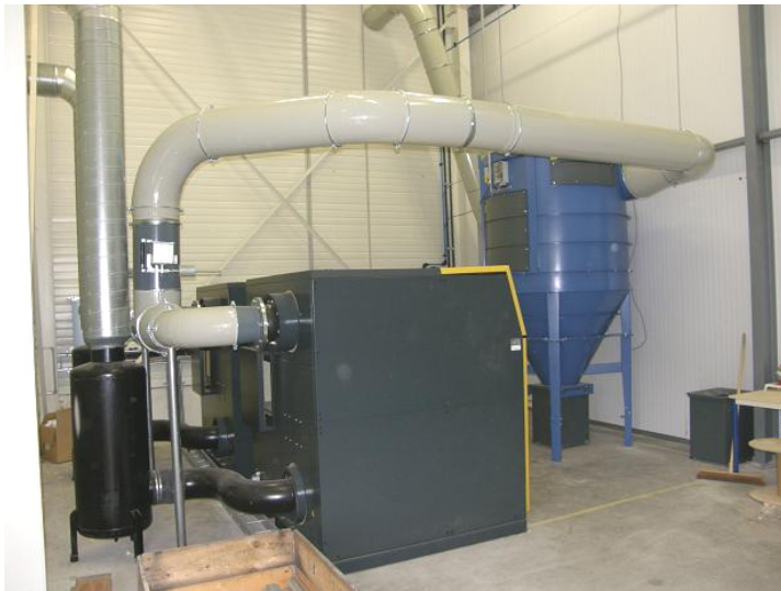
Opstilling i maskinhus
