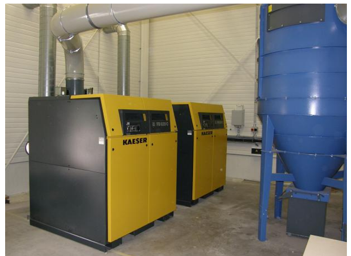
Vakuumpumper forbundet til filteranlæg
