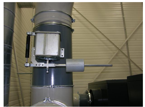
Vakuumregulering på vakuumpumper
